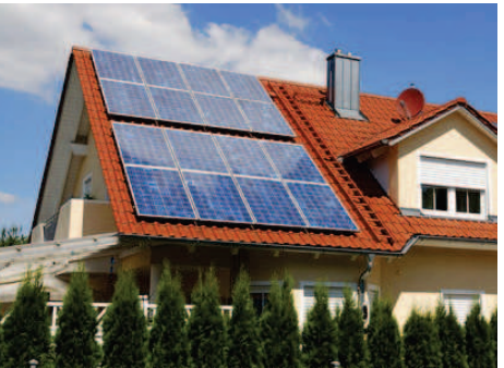
PV-Anlagen erzeugen Strom
