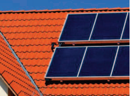
Solarthermie erzeugt Wärme zum Heizen
